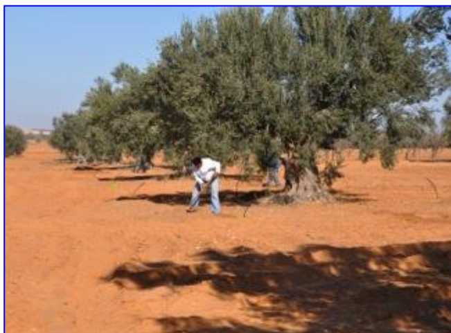
Installation des diffuseurs enterrés pour les oliviers d'une exploitation à Sfax, Sud de la Tunisie
