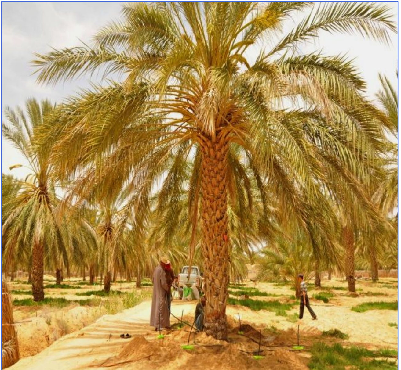
Installation des diffuseurs enterrés pour des palmiers dattiers (Deglet Nour) dans une exploitation dans l'Oasis de Douz-Kebili-Sud tunisien
